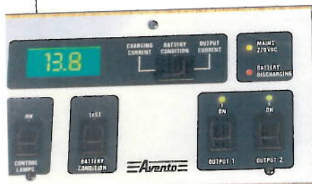
Het bedienings- en controlepaneel van de transformator/ acculader.
