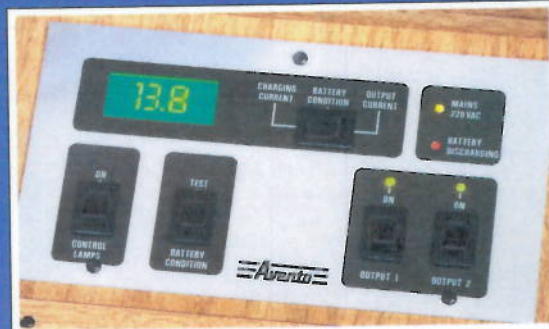
Het bedienings- en controlepaneel van transformator/acculader.
